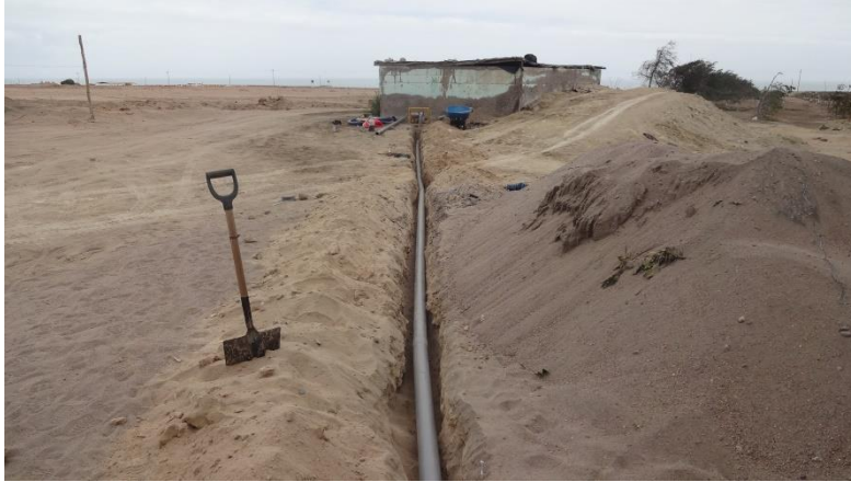
Fig. No. 42 Apertura de zanja y colocación de tubería matriz para riego por goteo
